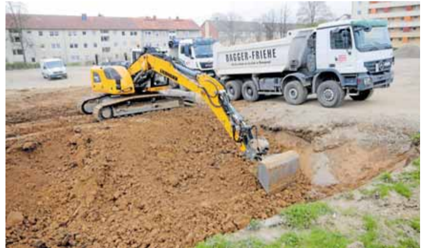
Noch steht beim Projekt Hochstraße alles im Zeichen des Tiefbaus. In dieser Woche soll der Hochbau beginnen.
